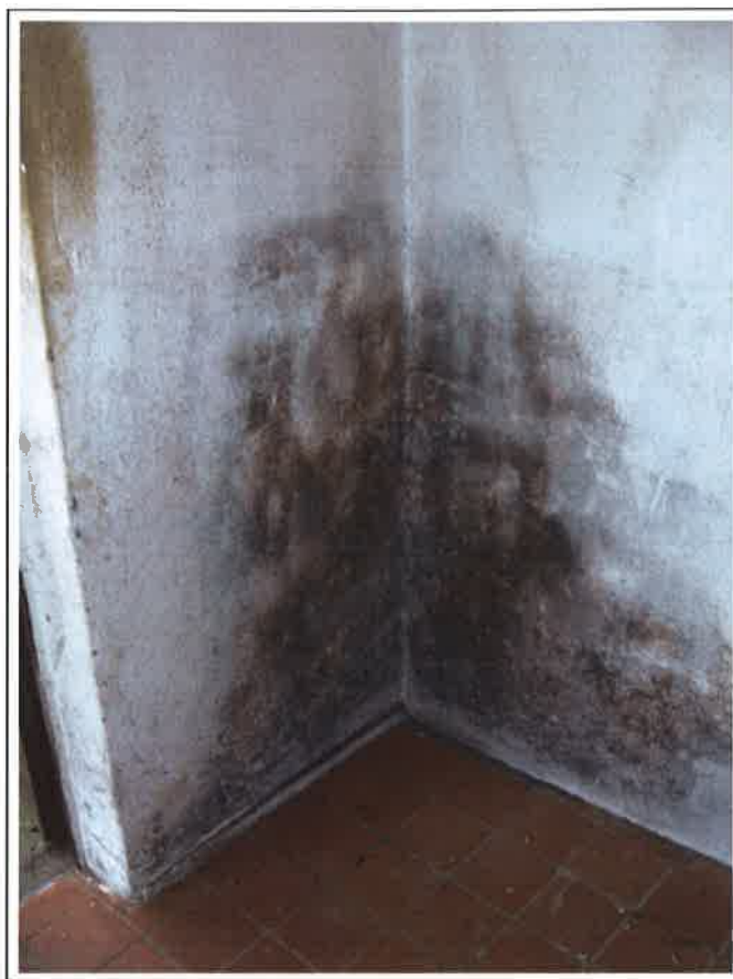
Foto 7 Ansicht von Feuchtigkeitsschäden und massiver Schimmelpilzbildung im Wandbereich des EG
