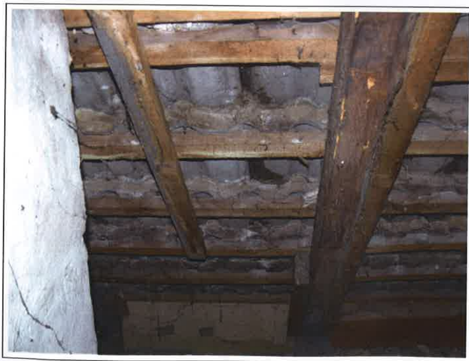
Foto 18 Beispielansicht Holzschädlinge im Dachgebälk
