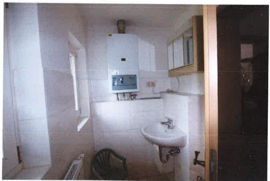
Sanitärbereich an der Südseite, Heizzentrale
